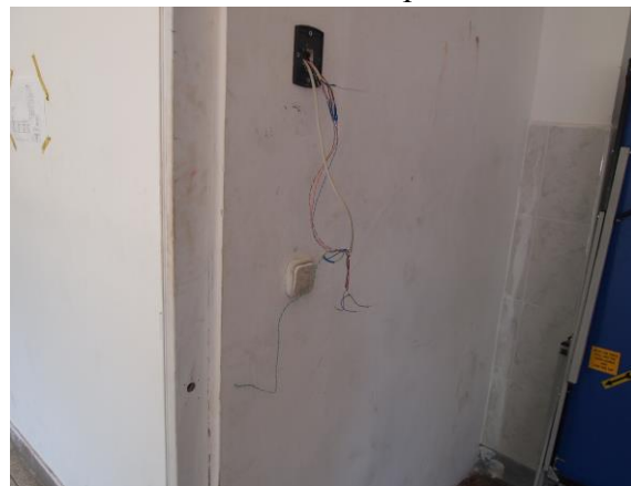
4. sz. kép: Vezeték az Otthon épületében
