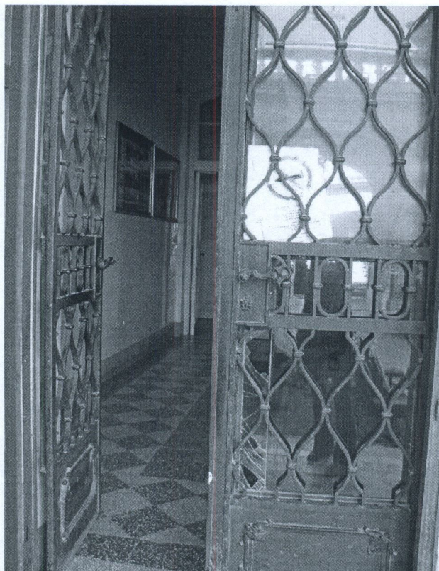
5. számú kép Törött üvegű bejárati ajtó
