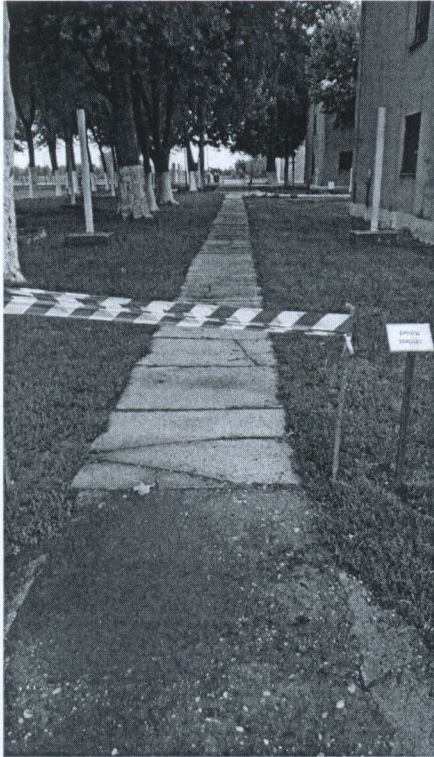
3. kép: töredezett járólapú betonút
